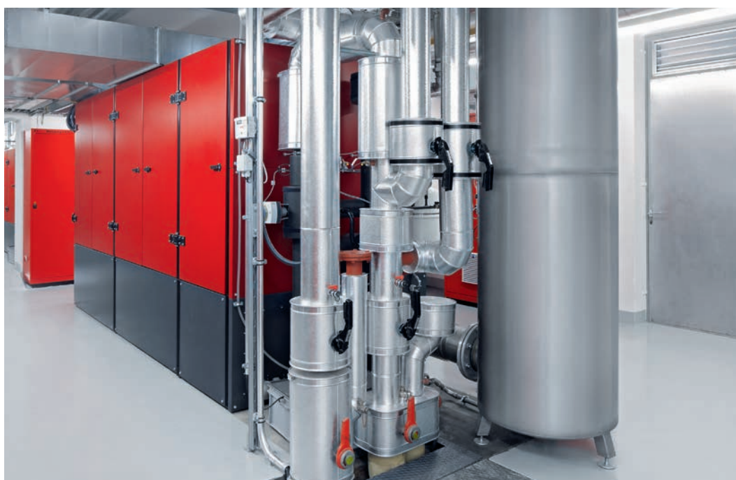
Bild 1: Blockheizkraftwerk (BHKW) mit einer Leistung von 240 \text{ kW}_{el} und 365 \text{ kW}_{th}
