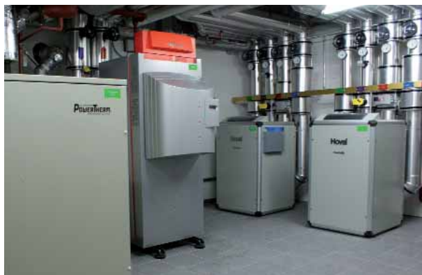
Das Gasmotor-Blockheizkraftwerk, der Gas-Kondensationskessel und die beiden Erdsonden-Wärmepumpen (von links).
